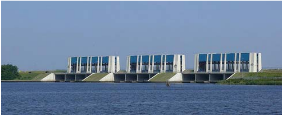
Figuur 21: Spuisluizen Lauwersoog: totaal 120 m opening
